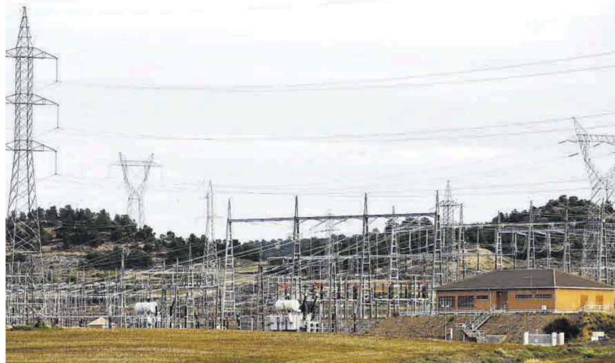
Subestación eléctrica de Peñaflor, una de las 16 en las que el ministerio debe convocar concursos para dirimir quién accede a ella.
