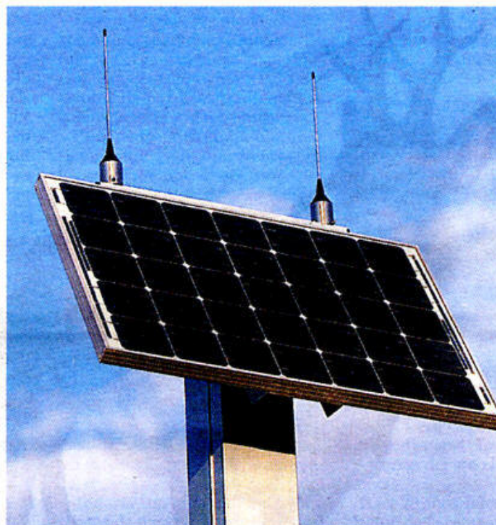
Se acaban de aprobar normas complementarias en energía solar.
