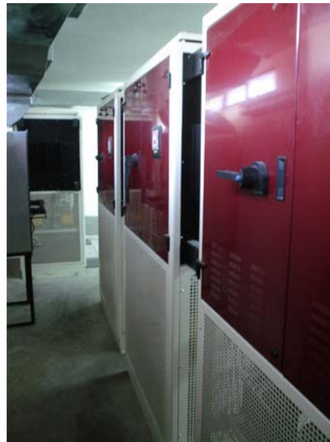
Compensación reactiva BT CIRVAC acería en Guatemala
