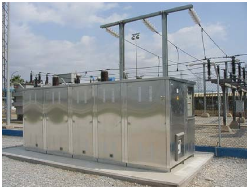
Subestación 220/6.6 kV Industria Química en España CIRKAP CMA 7.200 kvar 6.6 kV
