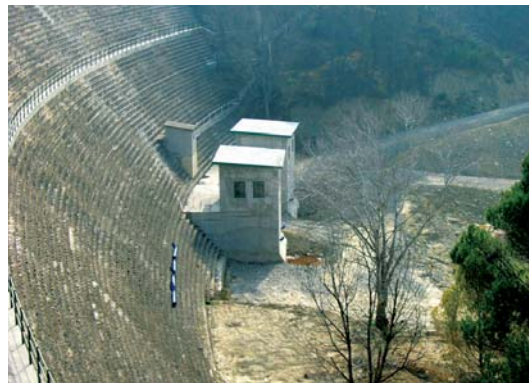
Figura 9.11. Central a pie de presa. Aprovechamiento de caudales ecológicos
