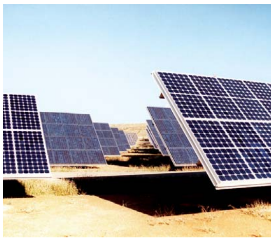
Figura 6.8. Huerta solar fotovoltaica
