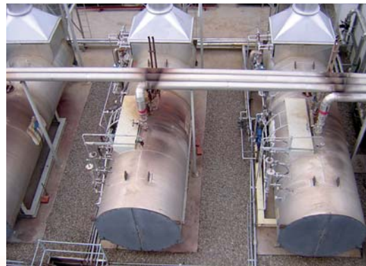
Figura 7.19. Instalación de cogeneración
