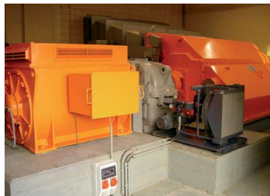
Figura 3.30. Turbina Francis. Central hidroeléctrica «Canal Roya»
