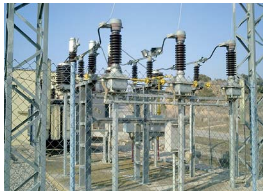
Figura 6.6. Punto de conexión en subestación transformadora
