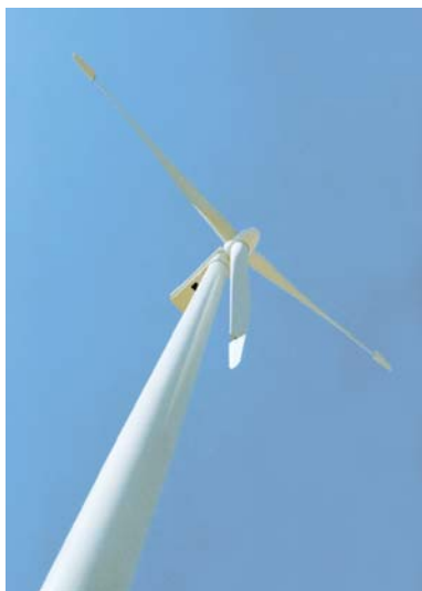
Figura 3.4. Aerogenerador de gran potencia
