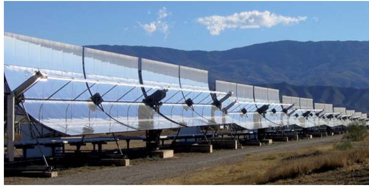
Figura 3.18. Instalación piloto en la Plataforma Solar de Almería
