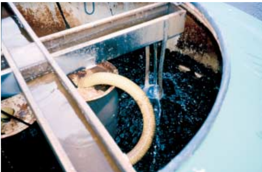
Detalle de la depuradora de aguas residuales.
