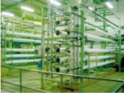
Detalle de la planta de ósmosis.
