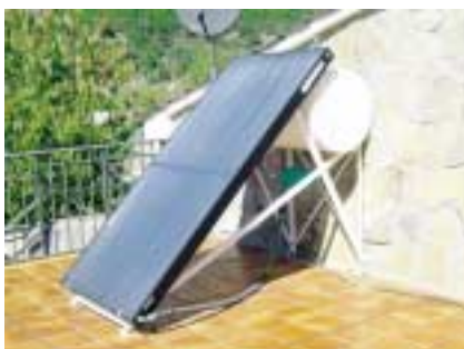
Colector para agua caliente.
