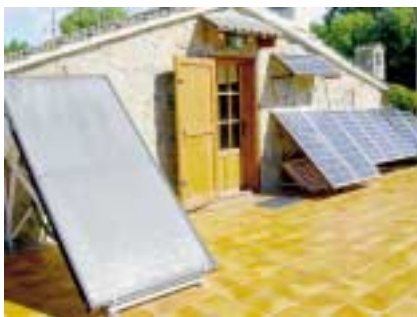
Placas solares fotovoltaicas.
