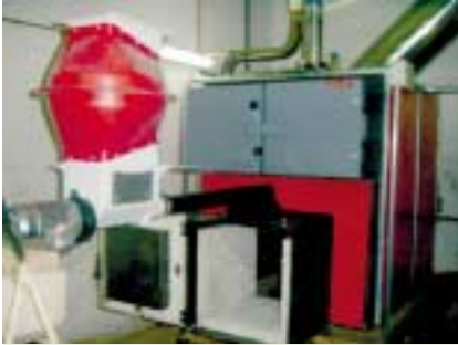
Caldera instalada en la comunidad de propietarios.
