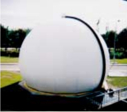
Gasómetro de doble membrana.
