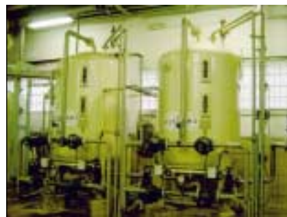
Planta de tratamiento de agua.
