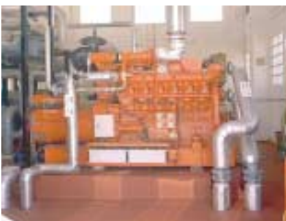
Vista del motogenerador.
