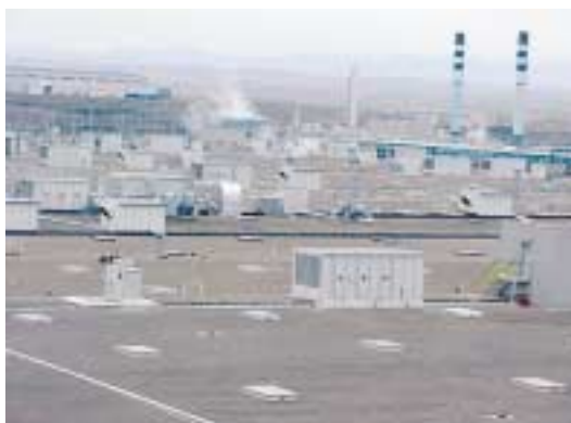
Sistema de climatización de la nave del edificio 51.
