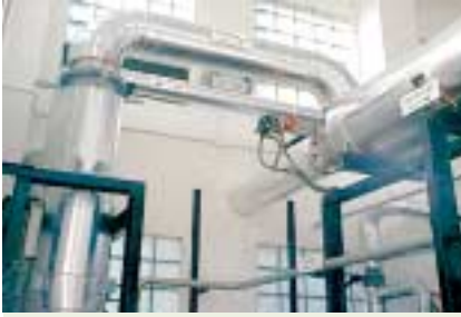
Intercambiador para el aprovechamiento del calor de los gases de escape.
